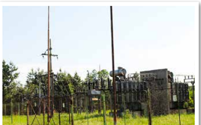
Poste de transfo
