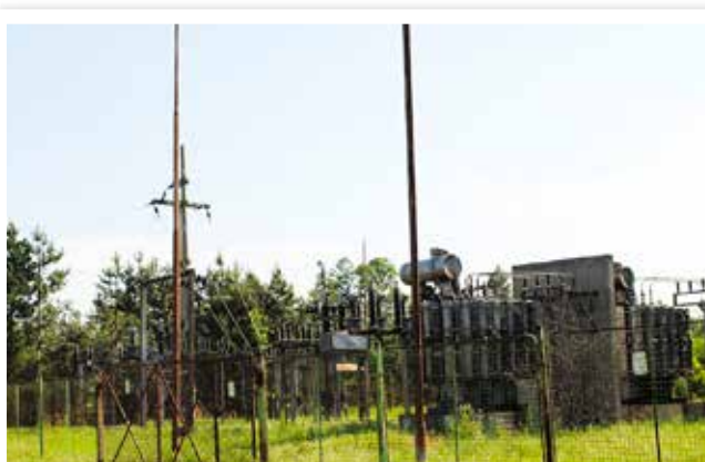
Cabina di trasformazione
